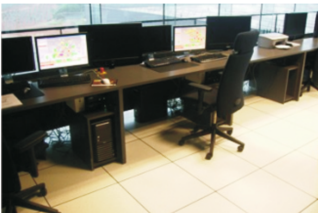
Salle de contrôle
