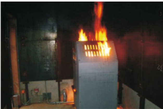
Feu de chaufferie
